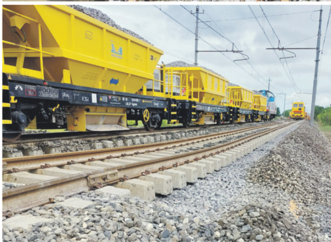
Sopra un binario della Romagna distrutto e sotto i lavori di ricostruzione
